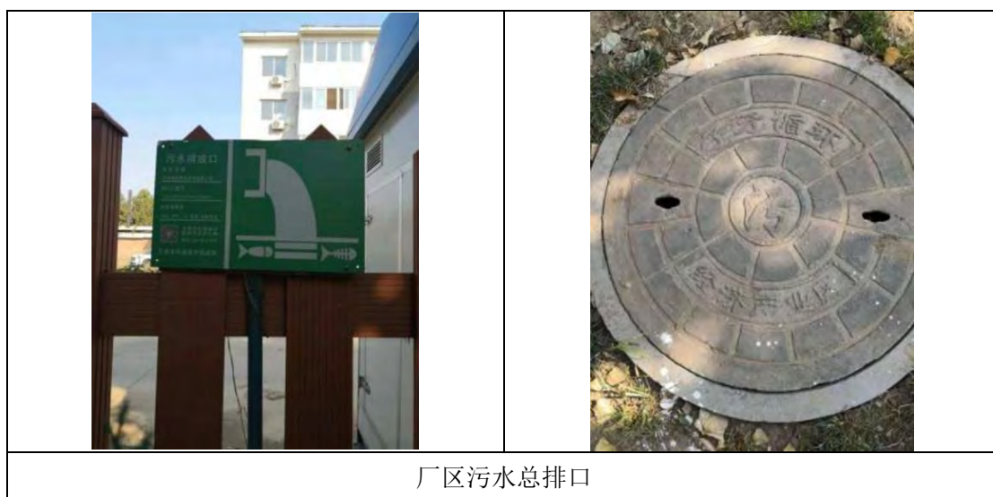
图 2.4-2 厂区现有污水排放口照片
